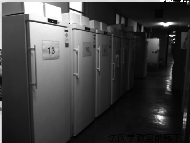
保管用冷凍庫
